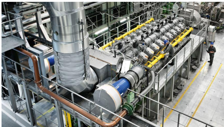
Gasmotor als Back-up-Kraftwerk bei Dunkelflaute
